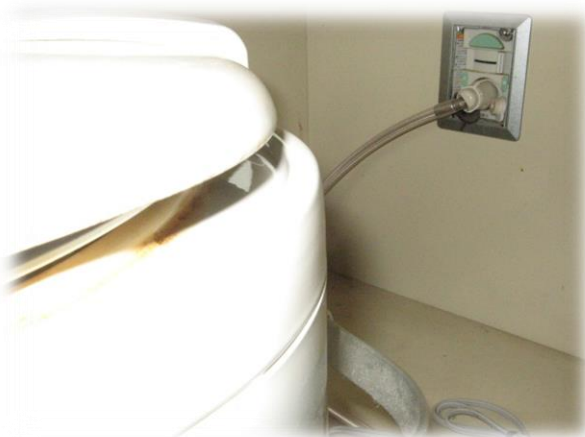
ガス管が壁よりつながっています
